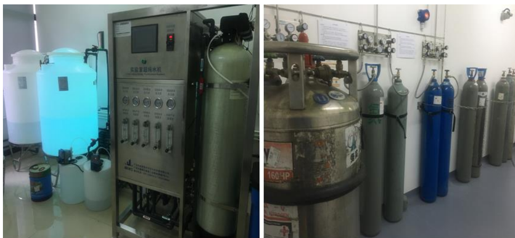
纯水系统和集中供气系统
