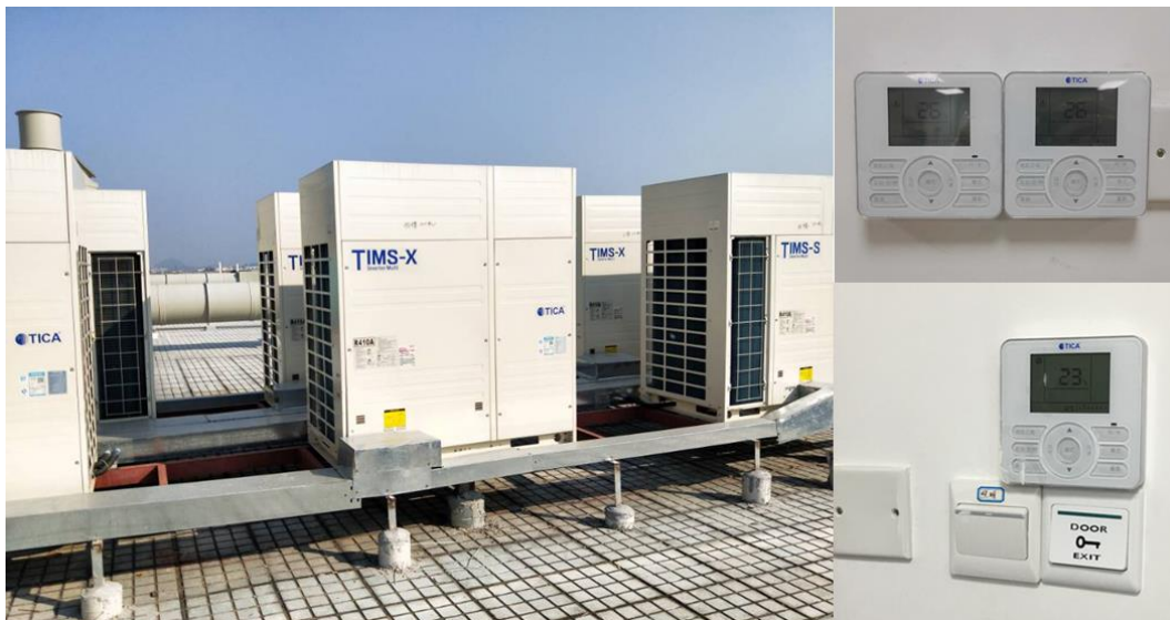
中央空调系统
