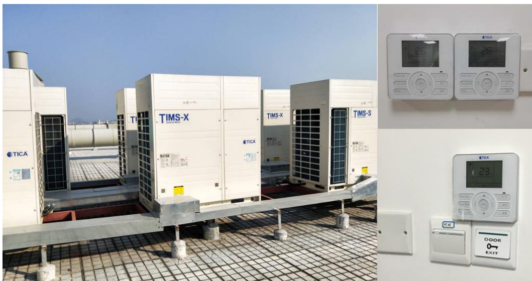
中央空调系统
