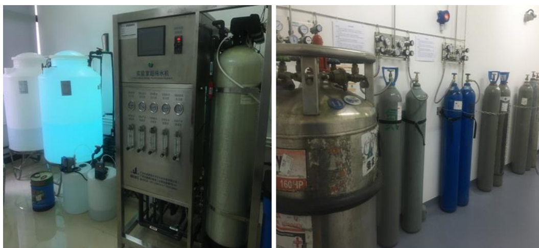
纯水系统和集中供气系统
